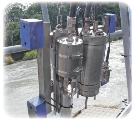
現場設置例 (試作機)
